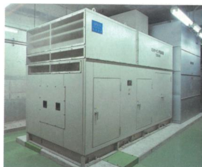
非常用発電機（鳩ヶ谷）
