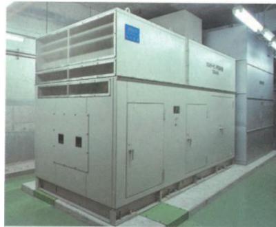
非常用発電機
